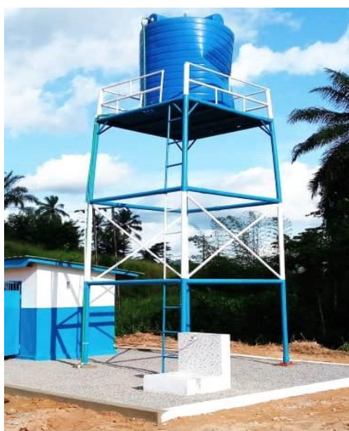
Forage d'eau avec réservoir muni d'une pompe solaire pour un Centre de Santé
